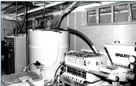
Abwasseraufbereitung Waste water treatment Traitement des eaux industrielles
