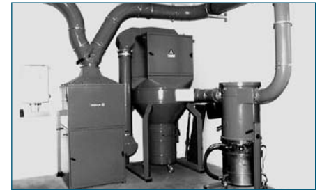
Absauganlage für Schleifstäube Extraction system for wheel dust Installation d'aspiration pour la poussière de meulage
